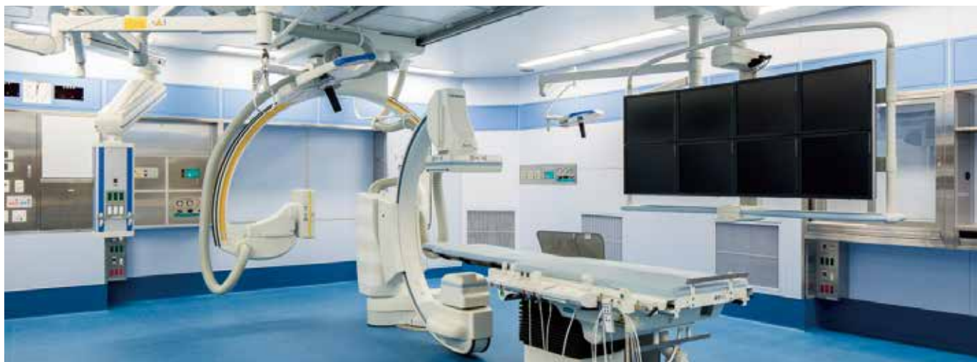
ハイブリッド手術室 / 手術室と血管造影室（カテーテル室）の機能を一体化させた手術室
